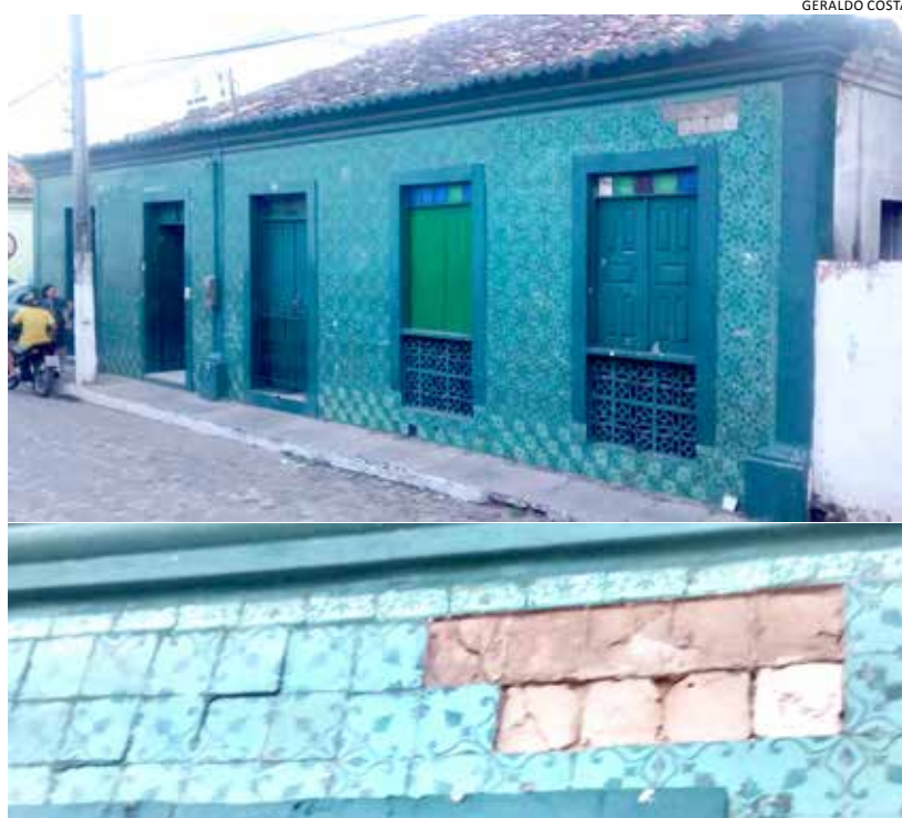
O casarão azulejado sede do cartório e, no detalhe, o local onde os azulejos estão descolando
